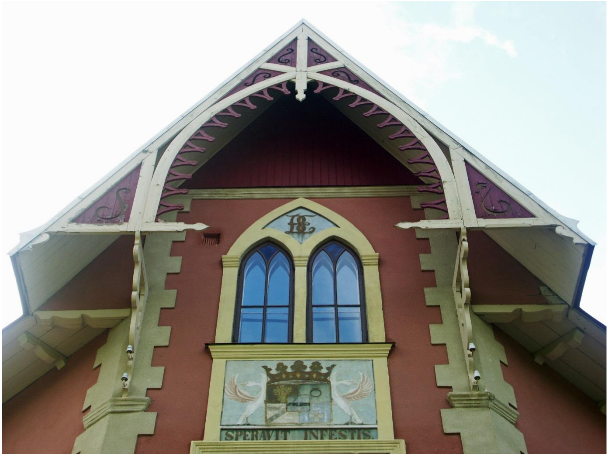
Villa uppförd på 1880-talet med förebilder i amerikansk villastil och schweizerstil. Spetsbågiga fönster inspirerade av gotikens formspråk. Göksbo, Altuna socken, Enköpings kommun.
