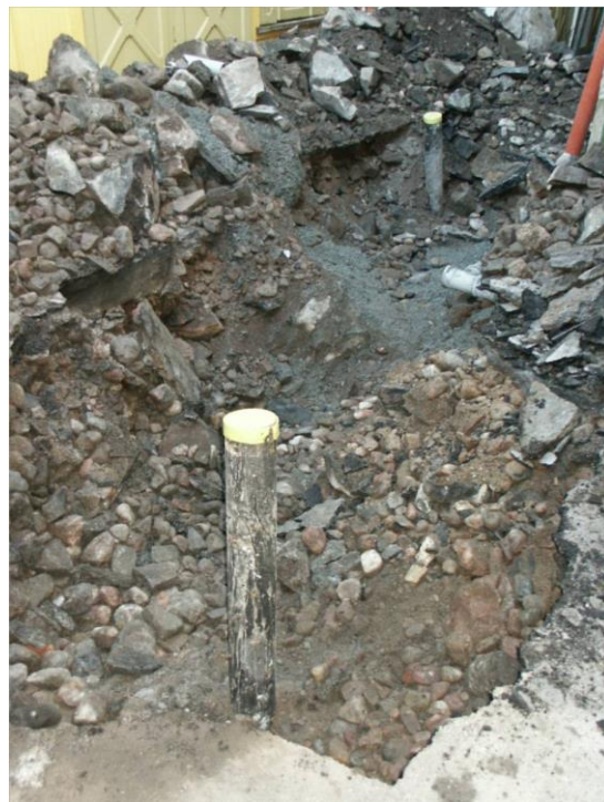
Figur 4. Detalj av schaktet vid ena borrhålet. Som synes av gruset och stenarna finns inget annat material inblandat. Troligen rör det sig om naturligt grusmaterial.
