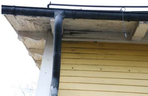
Hus 61, takfot vid sydvästra hörnet. Rötskador i takfot och panel. Stuprör av modern typ föreslås bytas.
