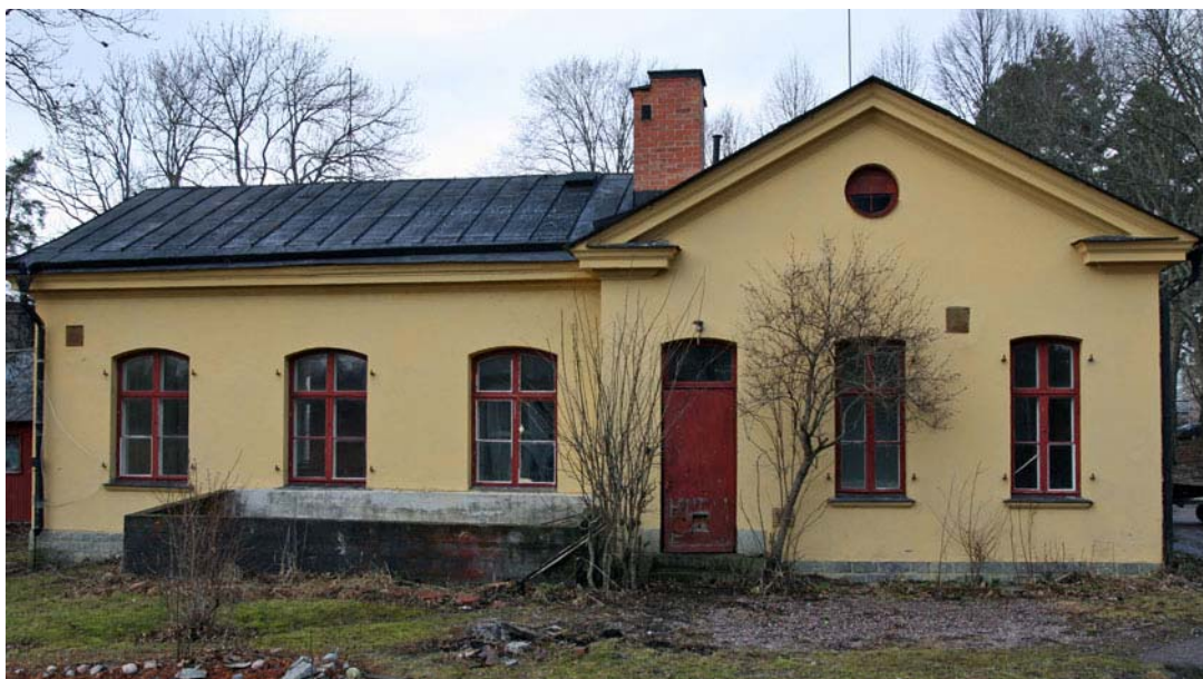
Hus 60, fasad mot söder. Det är viktigt att betongglädan framför fasaden, där en oljetank tidigare stått, rivs och att fasaden återställs.
