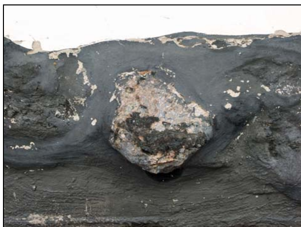
Sockeln på Hembygdsgården innan restaurering. Kalkavfärgningen från 1996 släpper från underlaget av gråsten och stenkols-tjära.
