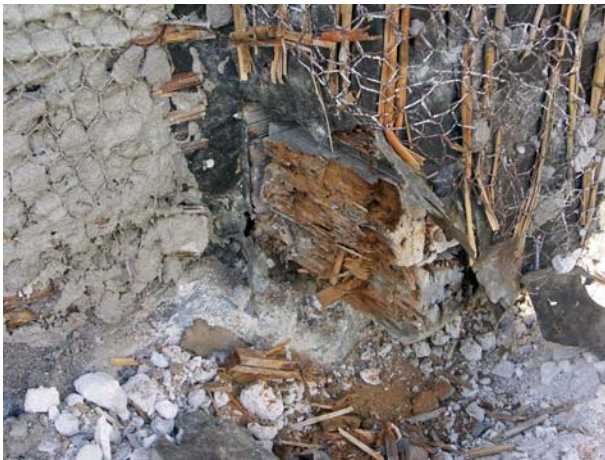
Gammalgårdens sydvästra knut efter borthuggning av dålig puts. Den vertikala knutstocken och den underliggande syllen har partiella rötskador.
