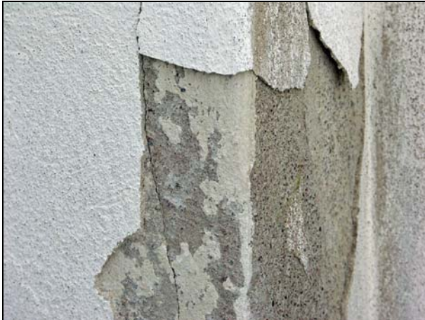
Gammalgården innan restaurering. Ytputsen spjälkar av i stora sjok. En tidigare, mer beige kalkavfärgning kan ses under ytputsen.
