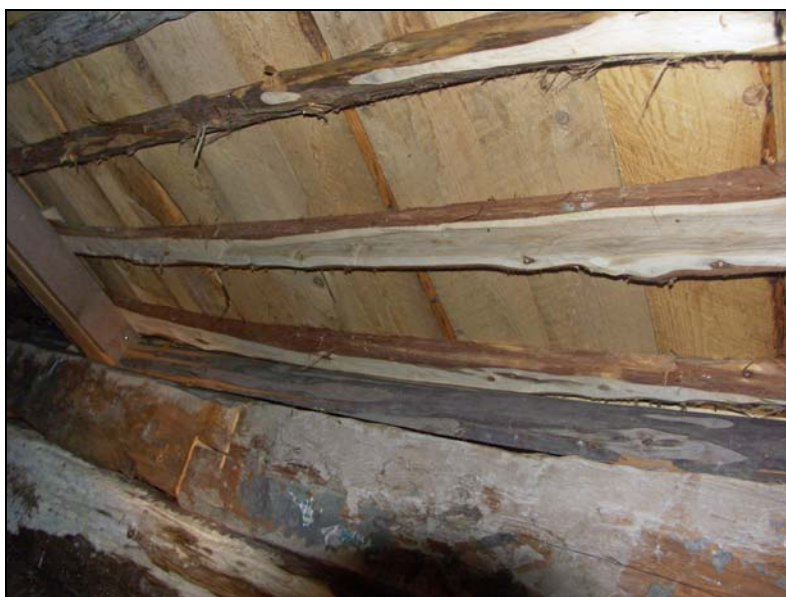
Delar av hammarbandet på norra långsidan var kraftigt rötskadat, och en ny stock skarvades in. Den nya stocken har tidigare suttit i ett boningsrum i en annan byggnad.
