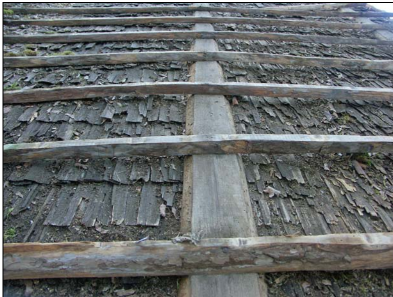
Manbyggnadens undertak innan restaureringen: Spjälkade stickspån i tre lager på öppen läkt, vankantade luftningsbräder och bärläkt.
