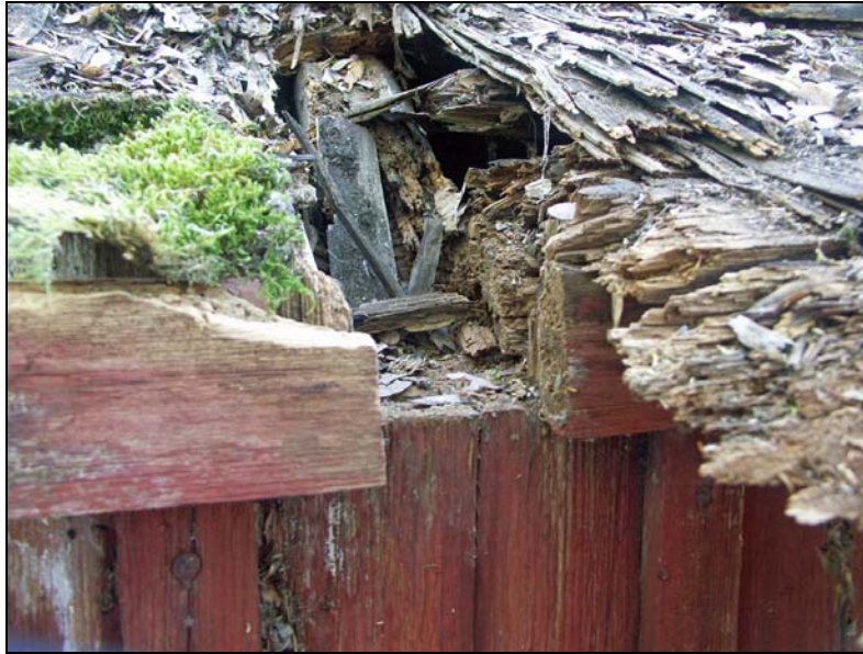
Rötskadad sparrända och hammarband på manbyggnaden. Vid restaureringen skarvades ett nytt stycke hammarband in, liksom ny sparrända.
