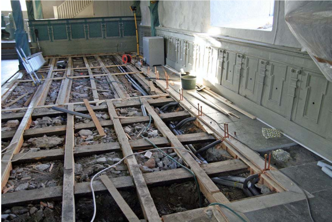
Det norra bänkkvarteret sedan bänkar och golv demonterats. Till vänster under golvbjälkarna ligger de nya värmeledningarna.
