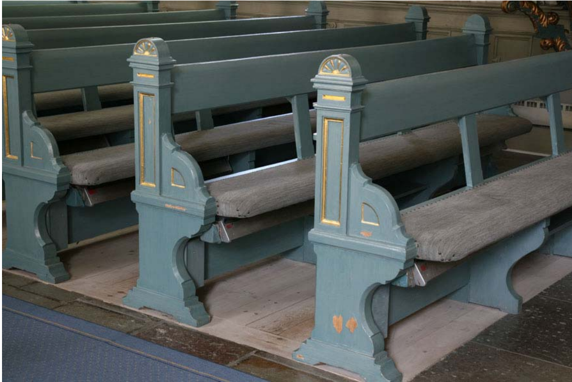
Här ses golvet och bänkarna före renoveringen. Bänkarnas ytskikt var skadade med flagnande färg.
