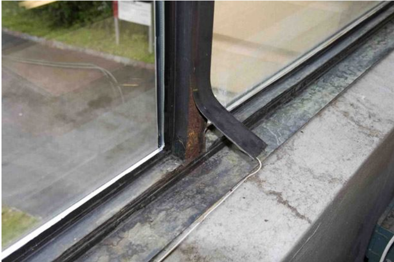
De gamla glaspartierna var rostiga och i dåligt skick. DIG005576
