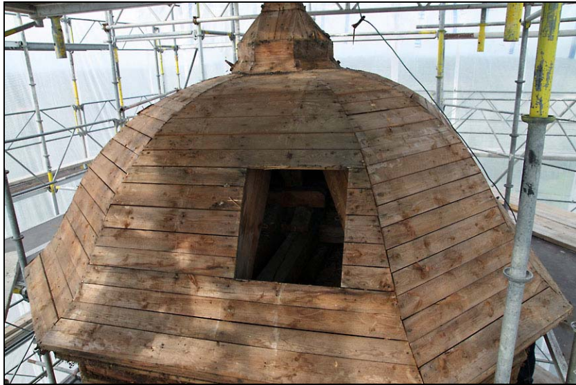
Toppkarnisens underbrädning var från omläggningen på 1930-talet och i förhållandevis gott skick.
