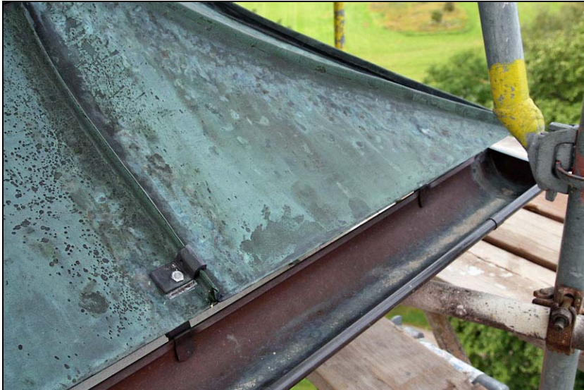
Tornets nedre takfall med hängränna. In- nan omläggning.
