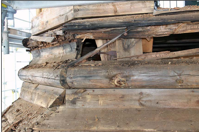
Vulstommarna var kraftigt rötskadade.
