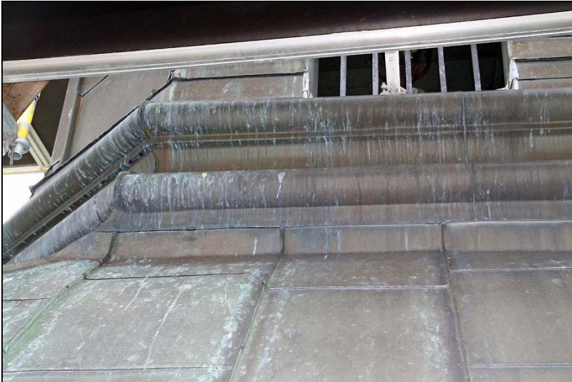
Vulster vid övergången från nedre takfallet till lanternen. Innan omläggning.
