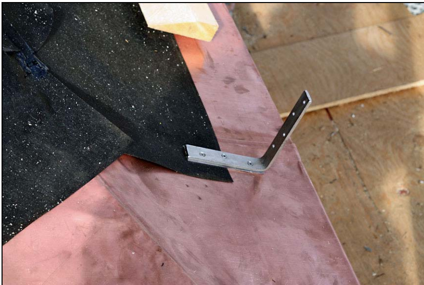
Nedre takfallet under omläggning. En stålkrok har satts upp för montering av fotränna.
