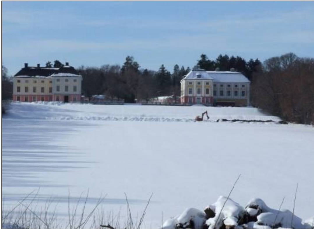
Figur 18. Schaktning över parterren vid Ekolsunds slott. Lägg märke till nivåskillnaden mellan parterren och den bakomliggande nedre terrassen. Det var nivåskillnaden och det självtryck för vatten som skapades som möjliggjorde de avancerade vattenkonster som funnits i trädgården. Foto taget från Vallen mot väster, Anna Ölund, Upplandsmuseet.
