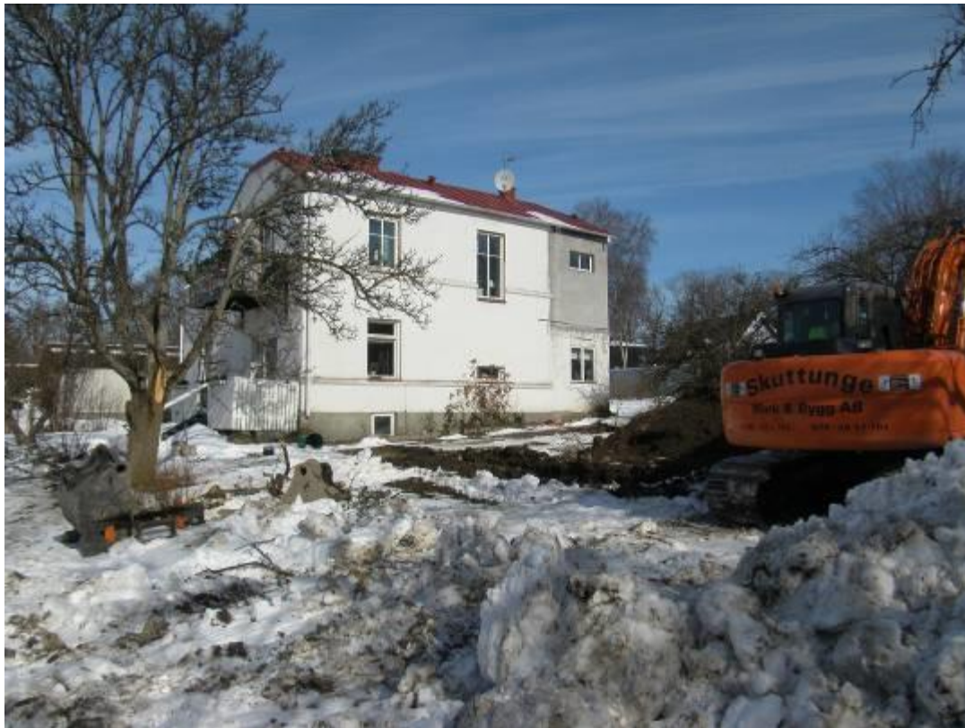
Figur 3. Översiktsbild från sydväst med de schakt som grävdes på fastighetens södra sida inom området för utbyggnaden. Foto (från SV) Dan Fagerlund, Upplandsmuseet.
