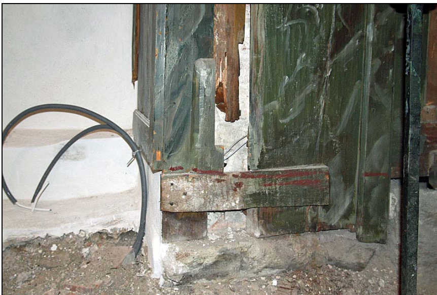
2010-02-09. Den nedre delen av predikstolens inklädnad hade relativt omfattande skador på delar som tidigare inte varit synliga.
