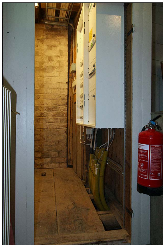
2010-06-03. Ny elcentral under läktaren.
