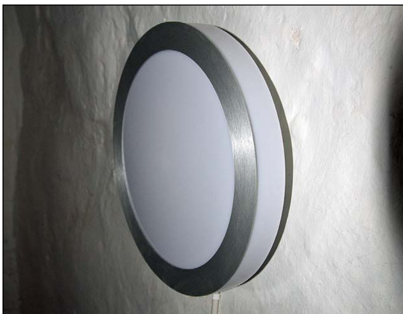
2010-06-03. Ny, väggmonterad plafondarmatur vid trappa till läktaren.
