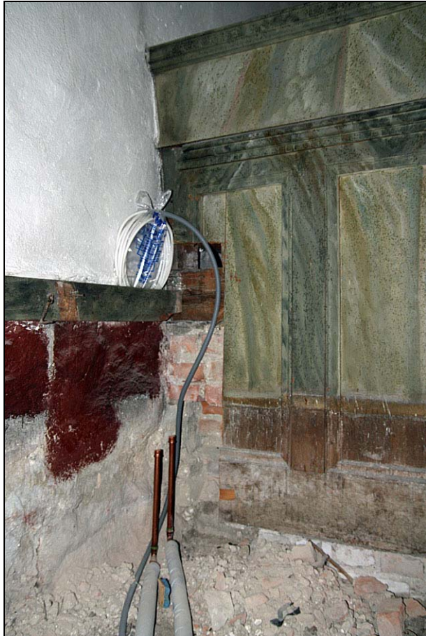
2010-01-26. Bänkfronterna i den övre delen av södra korsarmen var skadade mot väggarna genom tidigare installationer. Fronterna var omålade där de nedre bänkarnas ryggar tidigare satt. Fronter och nedre bänkkvarter tycks alltså ha tillkommit vid ett och samma tillfälle. Östra bänkfronten.
