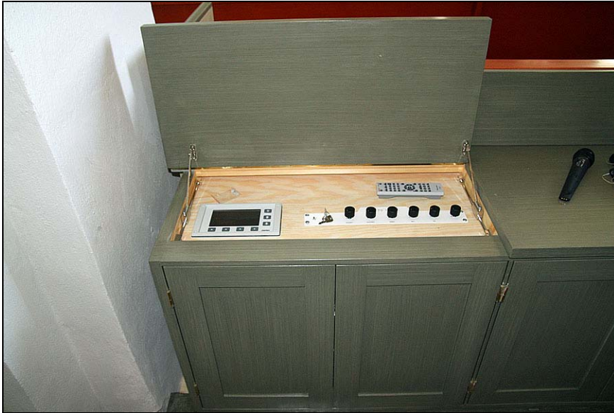
2010-06-03. Ny manöverpanel infälld i bänkskåp som avslutar långhus-kvarteren åt väster.
