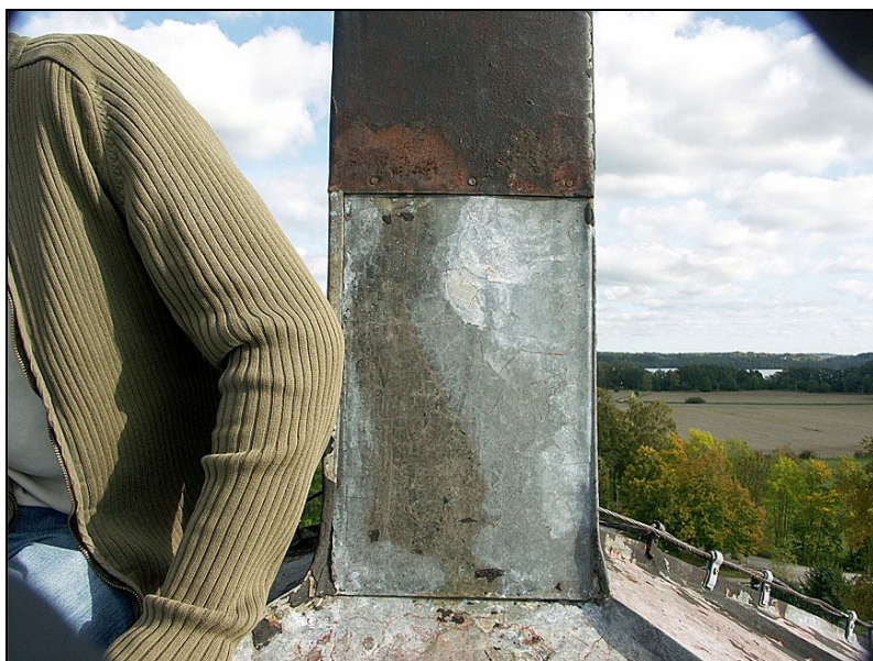
2008-09-24. Tornta- kets nyare galvanise- rade stålplåt möter krönkorsets gamla svartplåt.
