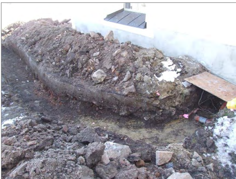
Figur 31. Bergvärmeschakt vid sakristian Foto mot SÖ.
