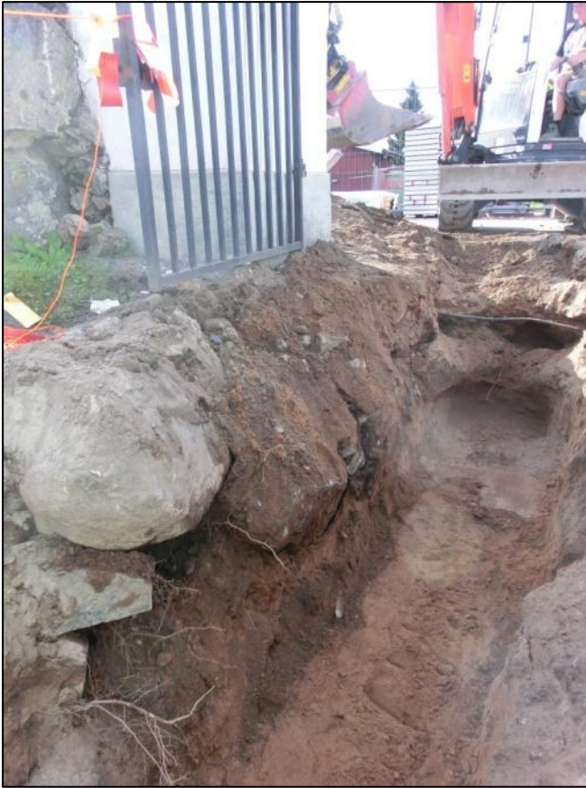
Figur 15. Schaktet genom grindöppningen. Ett par större stenar fanns direkt under markytan på östra sidan innanför grinden. I övrigt fanns endast mindre stenar direkt under marken vid ingången. Foto från norr, 2014-08-14.
