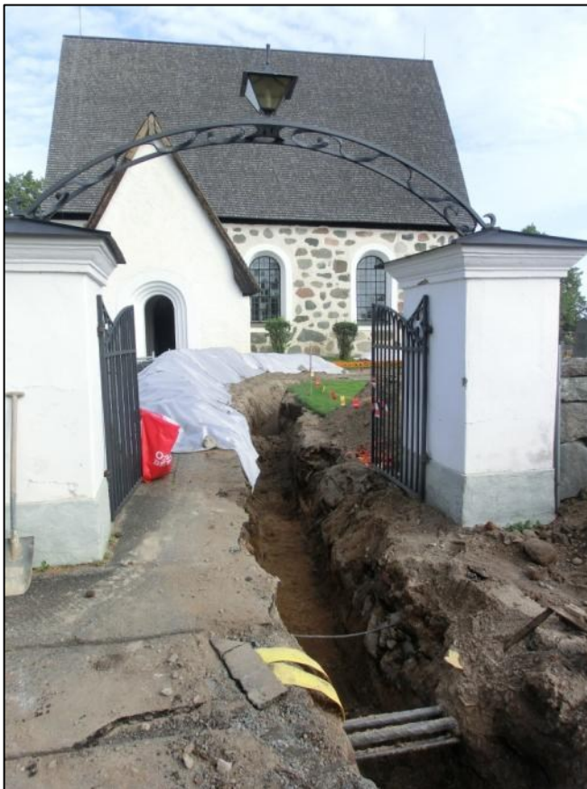
Figur 16. Schaktet genom grindöppningen. Utanför öppningen låg det nedgrävda elledningarna parallellt med bostadsmuren. Foto från söder, 2014-08-14.
