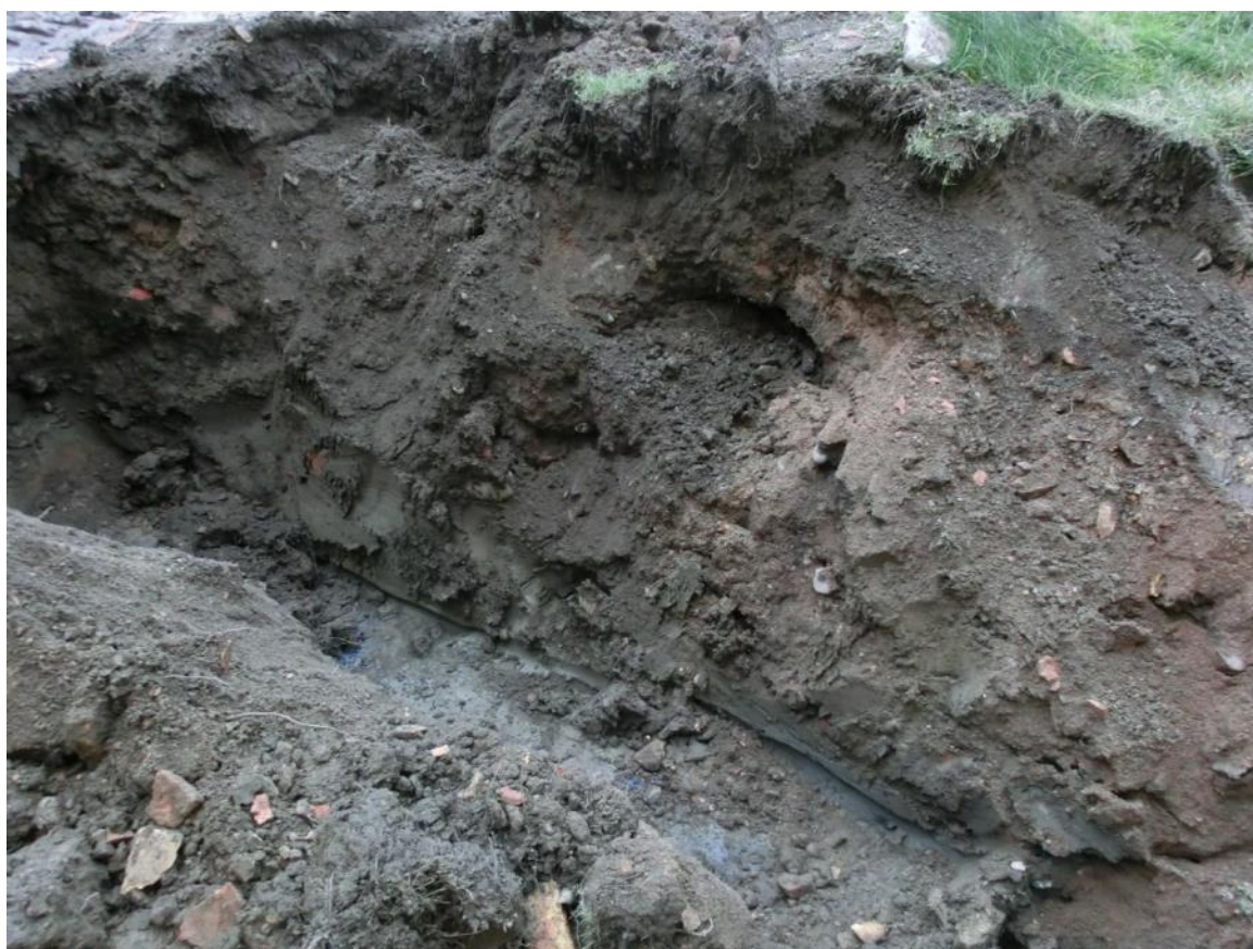
Figur 12. Foto av ett djupare schakt intill nedgången för nedläggning av dagvattenledning. Foto mot öster, 2014-11-17.
