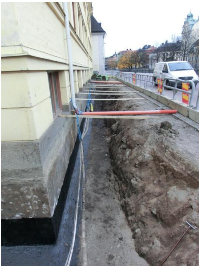
Figur 17. Schaktet för dränering utanför hus 2 efter att grunden fuktisolerats och dräneringen lagts ner. Foto mot nordväst, 2014-10-28.
