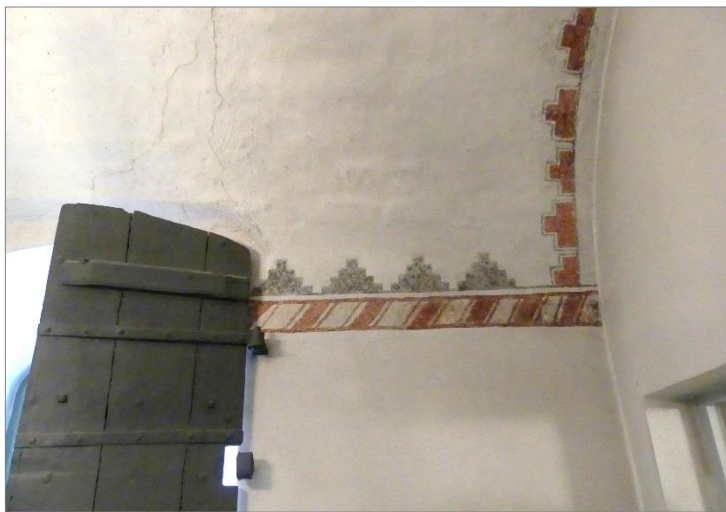
Figur 23. Sprickor och lagningar i måleriet i sakristians valv pekar mot att ombyggnationen även omfattat valven i sakristian. Foto mot N.
