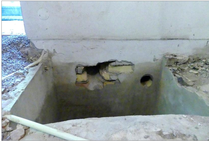
Figur 22. Mellanväggen i sakristian visade sig vara byggd av gult tegel. Denna är troligen uppförd i början av 1900-talet. Foto mot Ö.
