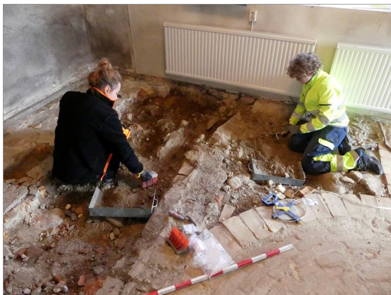
Figur 5. Emelie Sunding och Olle Höög gräver fram murar i sakristian. Foto mot NV.
