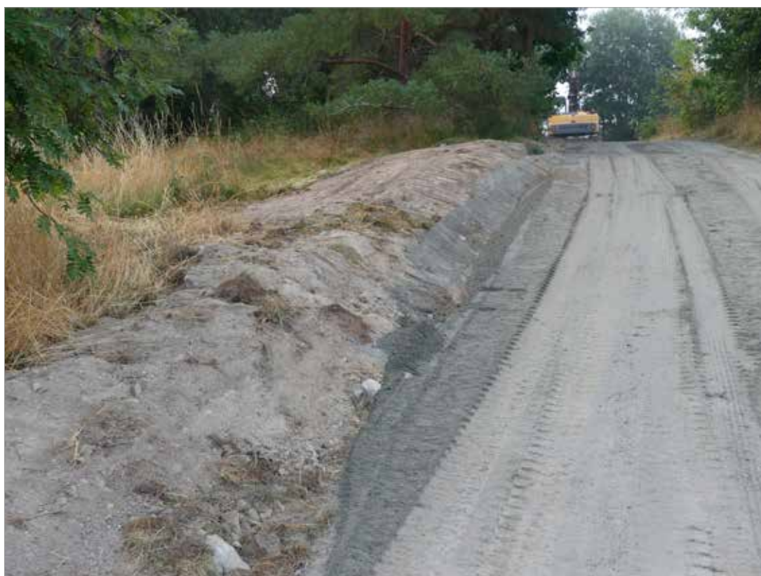
Figur 49. Strax norr om gravfältet gick berg i dagen och en låg vall anlades för att täcka fiberkabeln. Foto mot söder.
