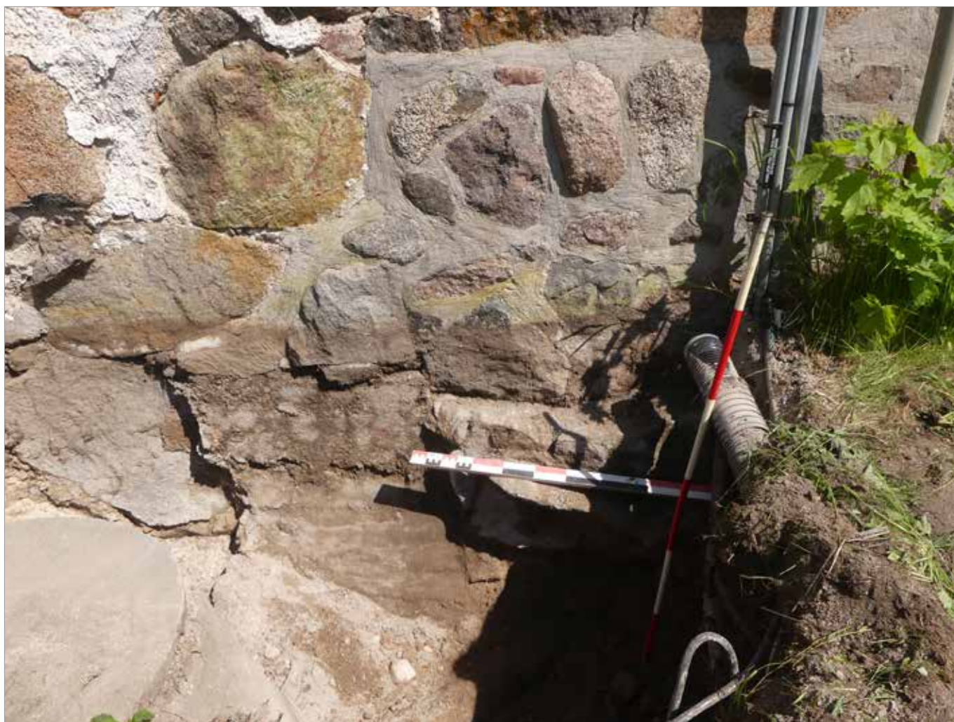
Figur 4. Schakt 1 med den cementtrumma där det nya avloppet skulle kopplas in till vänster i bild. Tröskelstenen syns i den högra kanten vid fotostickan. Notera dock att fotostickan vilar mot cement som som sitter fast på stenen. Även muren till vänster under fotostickan är cement. Foto mot öster Andreas Hennius, Upplandsmuseet.
