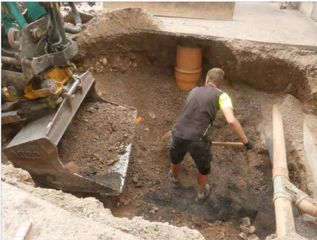
Figur 13. Den övre delen av schaktkanterna i schakt B rasade in, vilket medförde mycket skotning av grus och sten. Foto mot NV.
