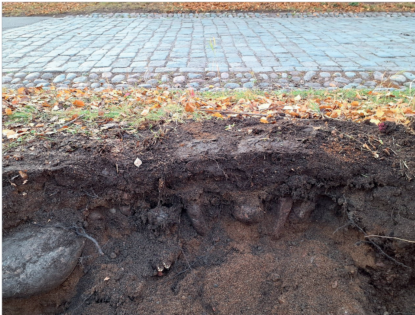
Figur 9. Kullerstensläggning under mark, i schakt 5.
